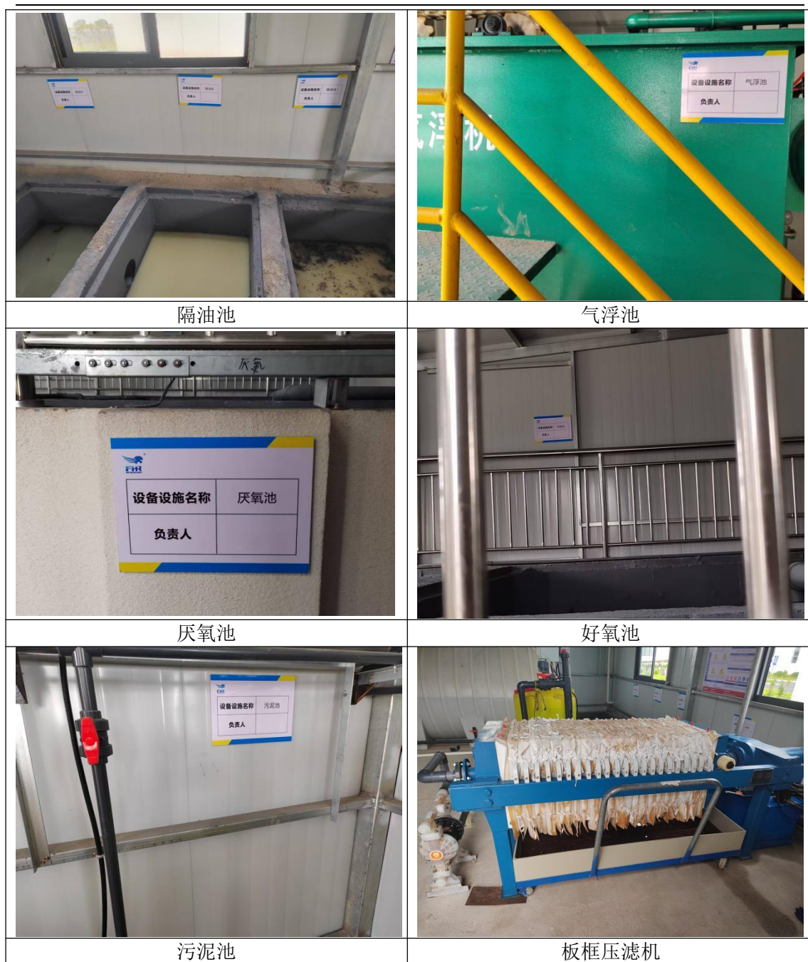
图 4-3 企业污水站照片
